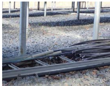
断線されたCVケーブル
