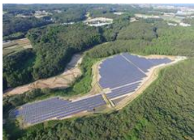
銚田市畑田第一発電所
