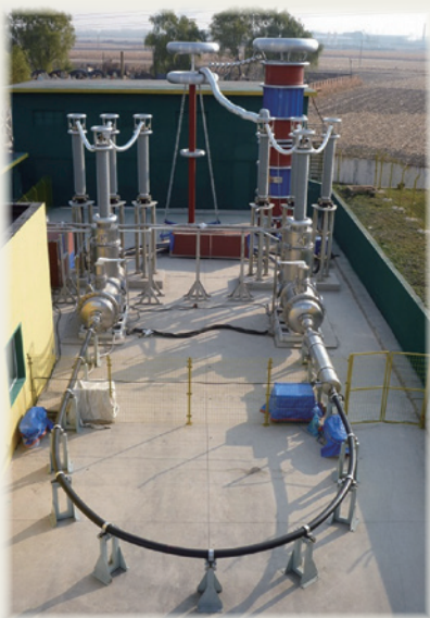
高温超電導電力ケーブル
