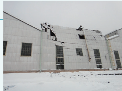
雪害直後の屋根が崩壊した工場
