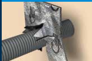
ケーブル・PF管側の開口
