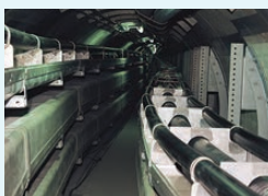
電力ケーブル
