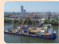
海底电力电缆
