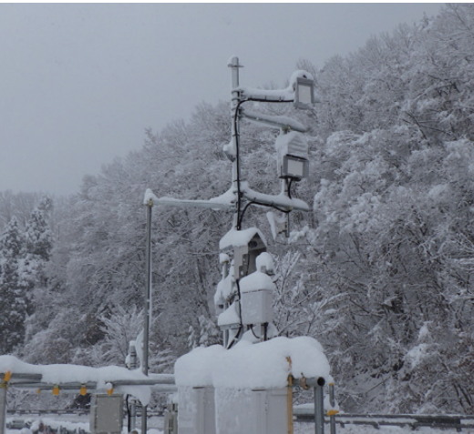
平成29年度 公募検証 降雪地域設置状況
