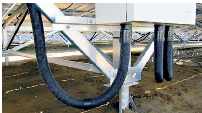
耐候性の求められる太陽光設備の機器周り
